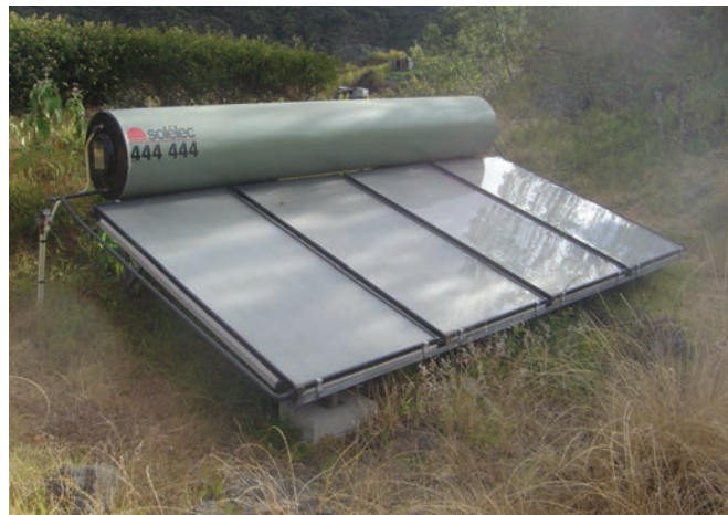
Calentador de agua con energía solar
